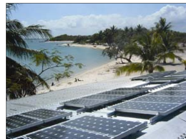
Solar array, Bawaka
